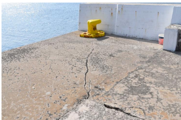
Εικόνα 3-15: Ρηγμάτωση στην ανωδομή πλησίον της δέστρας
