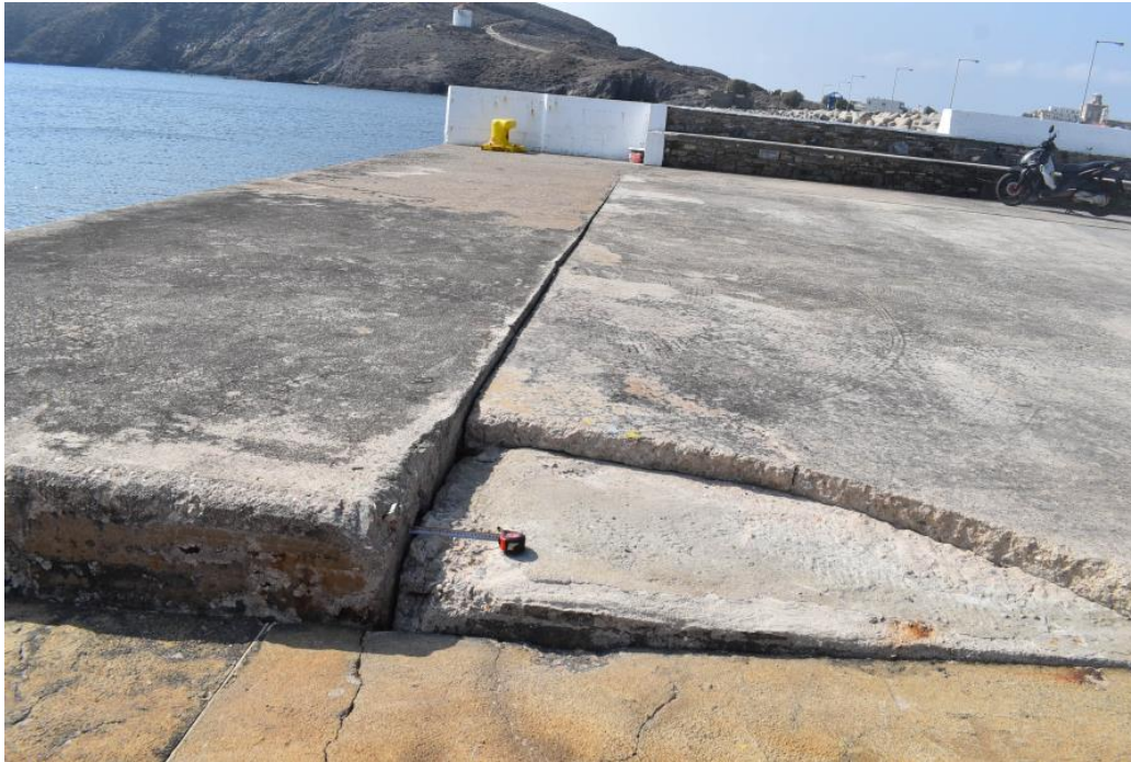
Εικόνα 3-18: Αποκόλληση τμήματος των χερσαίων επιστρώσεων πλησίον της διεπιφάνειας ανωδομής και ράμπας
