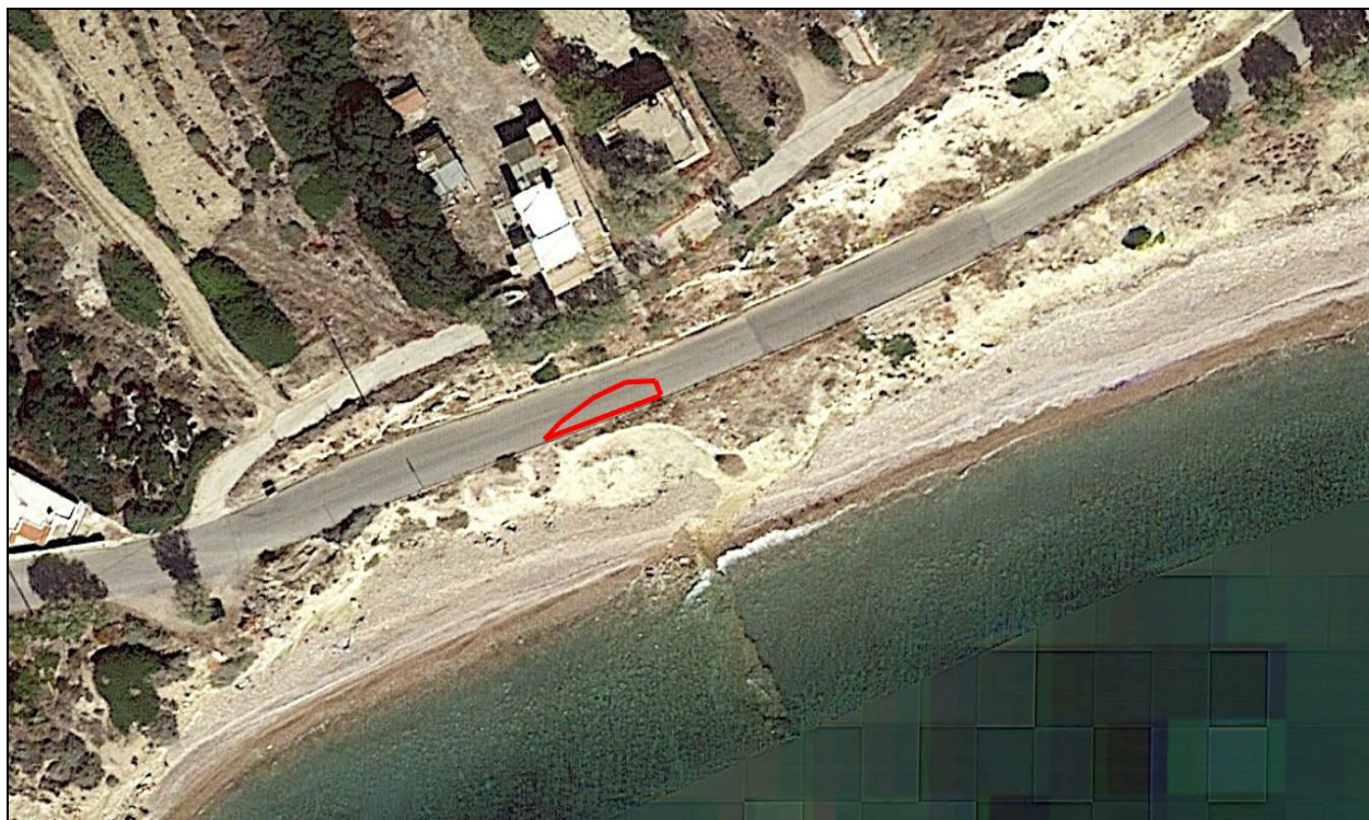
Εικόνα 3 Τμήμα οδού που υπέστη βλάβη επί αεροφωτογραφίας (πηγή Google Earth).
