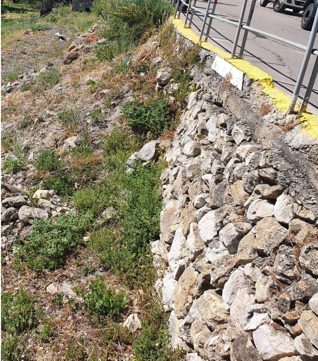
ΦΩΤΟΓΡΑΦΙΑ ΟΨΗΣ ΠΕΤΡΟΤΟΙΧΟΥ ΠΡΟΣ ΕΠΙΣΚΕΥΗ ΣΤΗΝ ΠΕΡΙΟΧΗ ΗΡΩΩΝ
